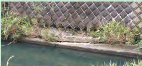
大山田川護岸の洗堀部分を発見
