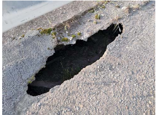
川の流れによって掘れてしまった路肩
