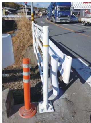
新設されたガードレール
