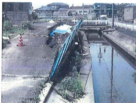
No.0+33付近の地割れ
