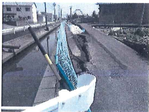
No.0付近の地割れ
