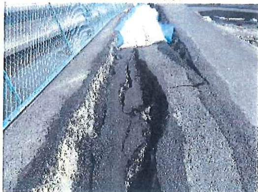
No.0+13付近の地割れ
