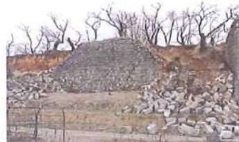
⑤⑦本丸北面崩落状況
