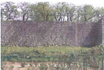
⑤⑦本丸北面崩落前
