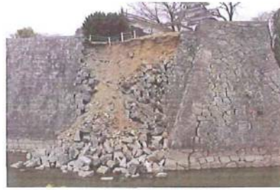
③竹之丸南面西崩落状況
