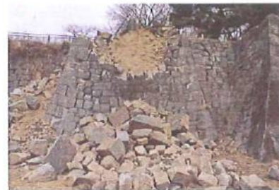
④月見櫓跡崩落状況
