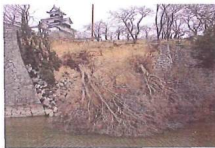
②竹之丸南面崩落状況
